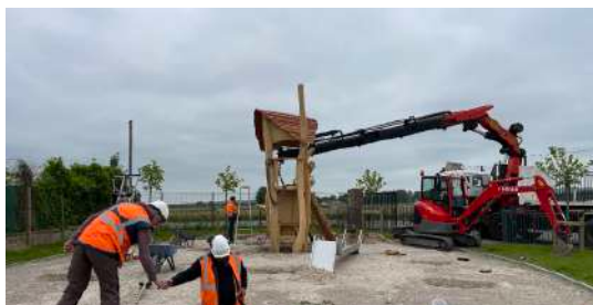
Construction de la nouvelle aire de jeux pour enfants au Complexe Albert Loquet
