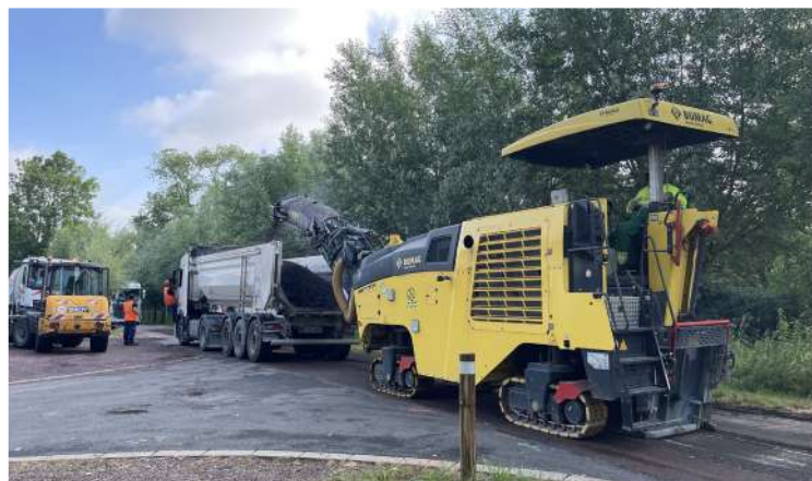
Réfection partielle de la chaussée des rues Couteau, de l'Épinette, de la Rivière 1777, chemin du Halage et Avenue du Lac.
