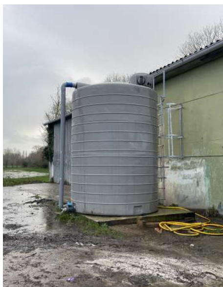
Aquisition de nouveaux récupérateurs d'eaux pluviales
